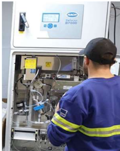
Mantenimiento SMCC complejo
