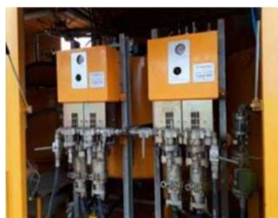
Bombas de inyección
