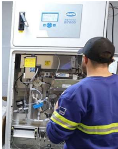
Mantenimiento SMCC complejo
