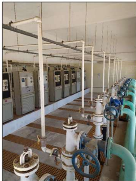
Sala de cloradores
