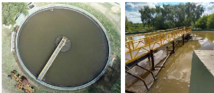
Sistema de extracción de Lodos
