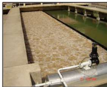
Lavado: etapa de soplado
