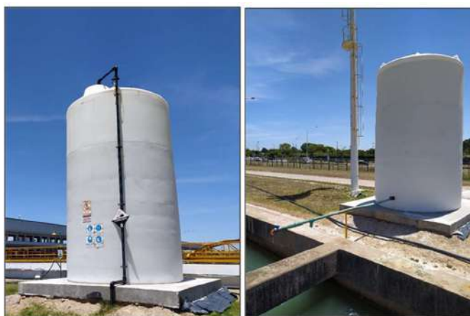
Tanques de almacenamiento de hipoclorito de sodio
