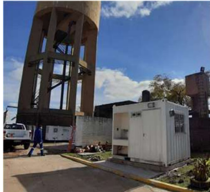
Instalación SMCC en estructura de tipo marítima en AMBA
