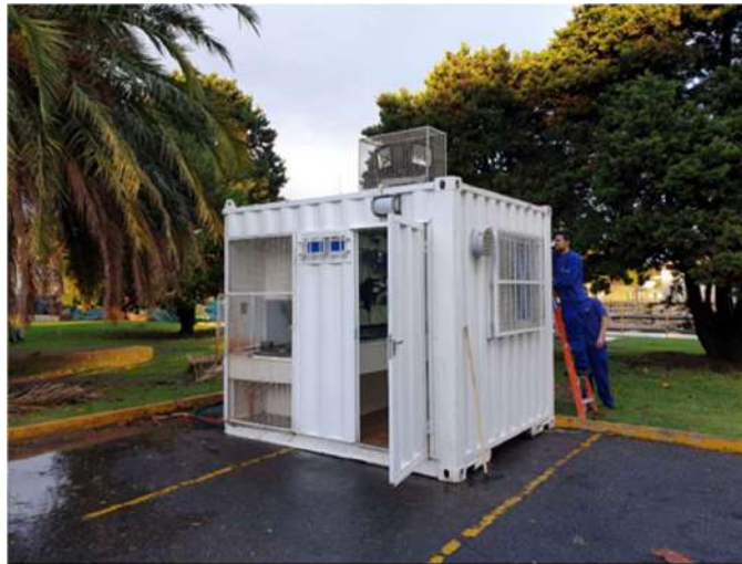
Instalación de SMCC Reserva D
