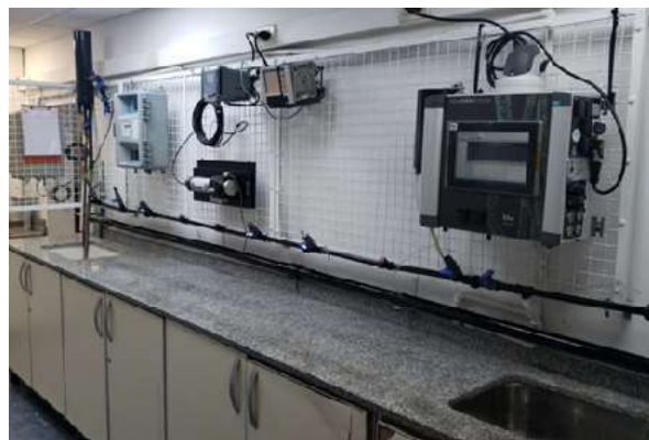
Panel de Equipos Muletos
