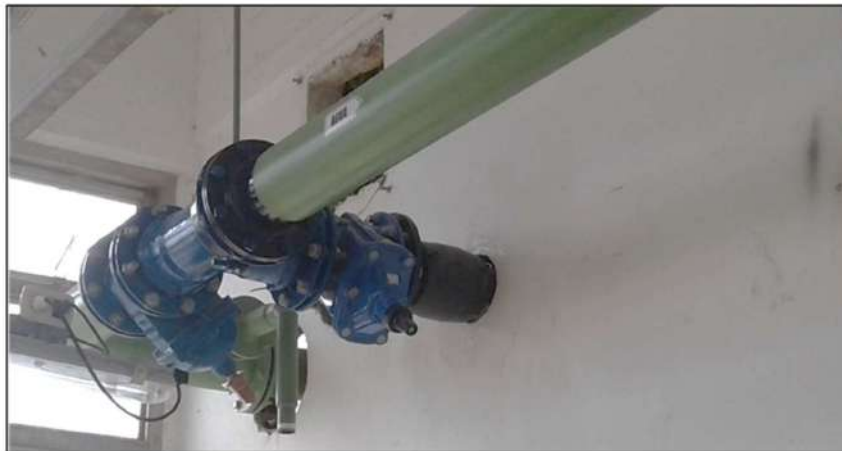
Cañerías de agua potable y agua filtrada para alimentación de preparadores de polielectrolito
