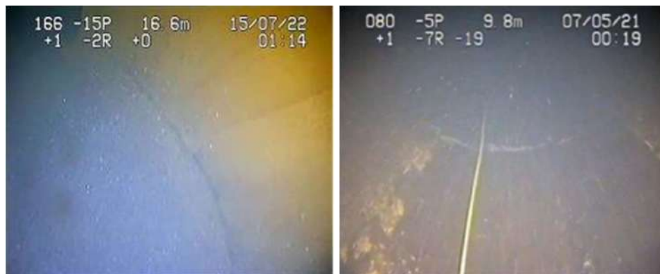
Imágenes del conducto durante las inspecciones
