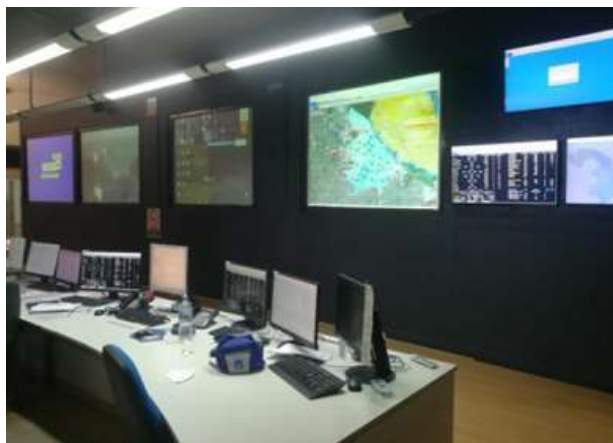
Control Centralizado de Agua - Sala de Control
