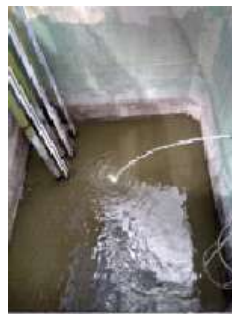
Cámara de Llegada/ Rejas
