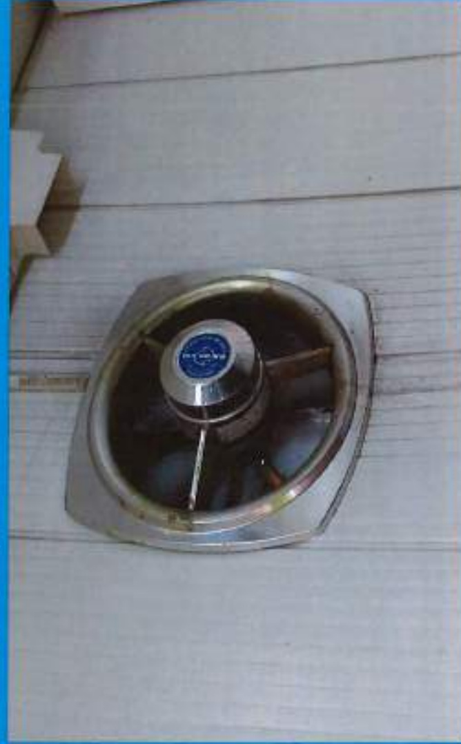
Sistema de ventilación de la Estación Fecha de relevamiento: 2/08/2017
