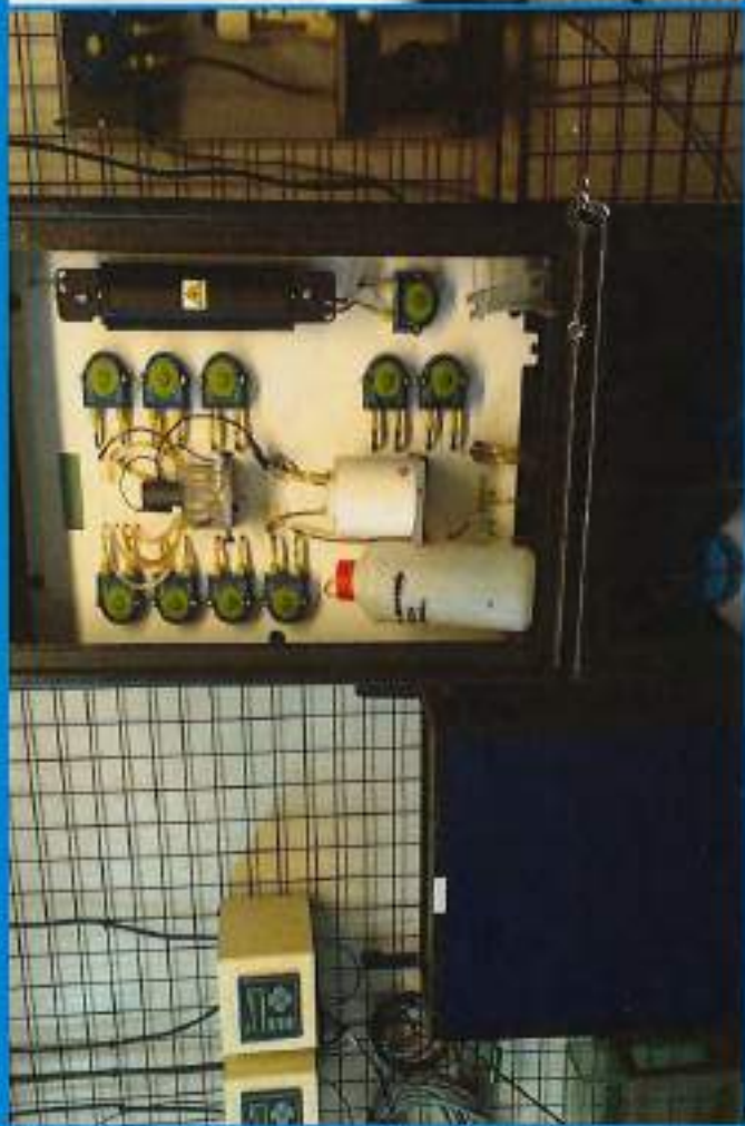
Medidor de cromo total continuo con sistema digest sin la identificación patrimonial Fecha de relevamiento: 1/08/2017
