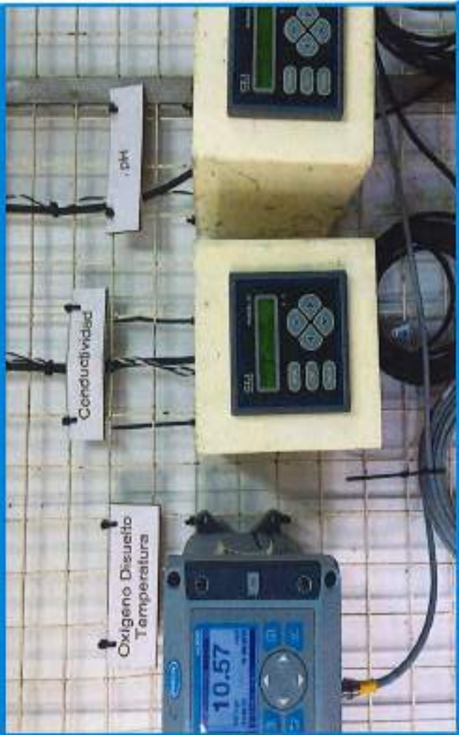
Medidor de Oxígeno disuelto marca Hach con identificación patrimonial incorrecta; Medidor de Conductividad marca GLI Internacional; y Medidor de Ph marca GLI Internacional sin la identificación patrimonial Fecha de relevamiento: 2/08/2017
