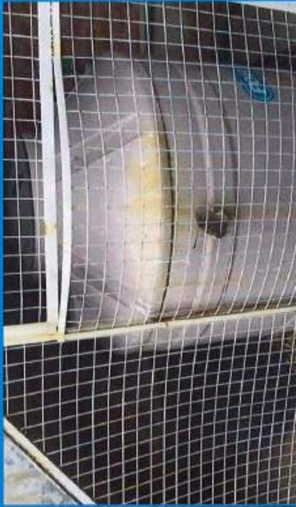
El tanque de agua está inaccesible Fecha de relevamiento: 1/08/2017
