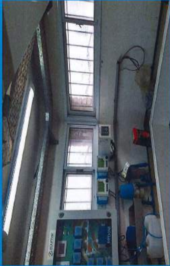
Equipamiento de medición de la Estación de Regatas sin la identificación patrimonial Fecha de relevamiento: 1/08/2017
